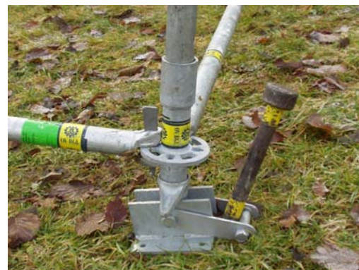
Gesicherter Behälterfuß Abb. VII / 25
