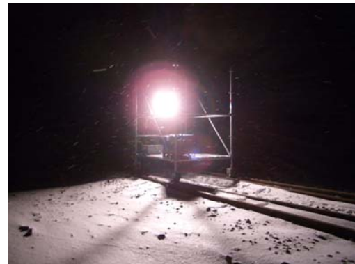
Ausleuchtung des Gleisweges Abb. VIII / 11
