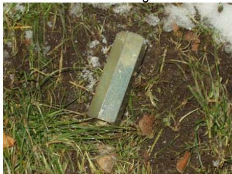
Erkennbarkeit der Ankerstäbe durch Gelbverzinkung (Abb. A / 38)
