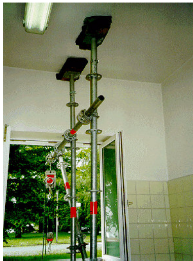
Innenansicht des Einspann-Auslegers (Abb. III / 19)
