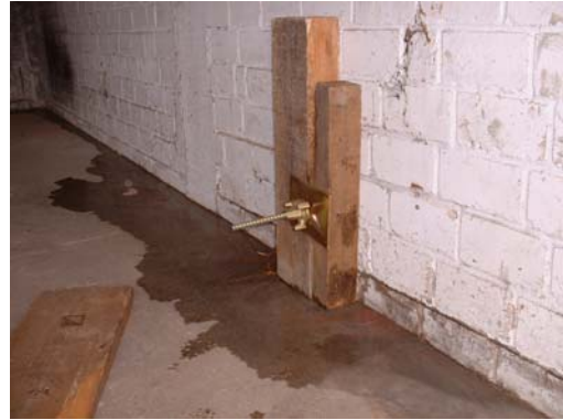
Innenseite der abgestützten Wand (Abb. A / 58)
