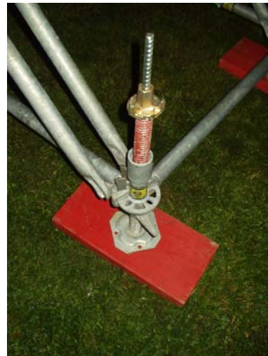
Sicherung einer Wandabstützung: Die Fußplatte wird mit durchgetriebenem Ankerstab und Flanschmutter gesichert.
