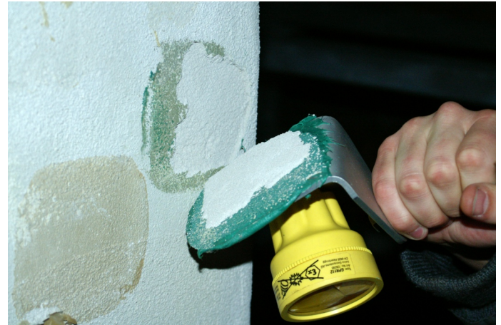
Die Anhaftung übertrifft nach kurzer Zeit die Kohäsion von Putz (Abb. II / 19)
