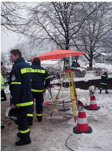
Aufbau mit Absicherung und Witterungsschutz im Einsatz (Abb. II / 11)
